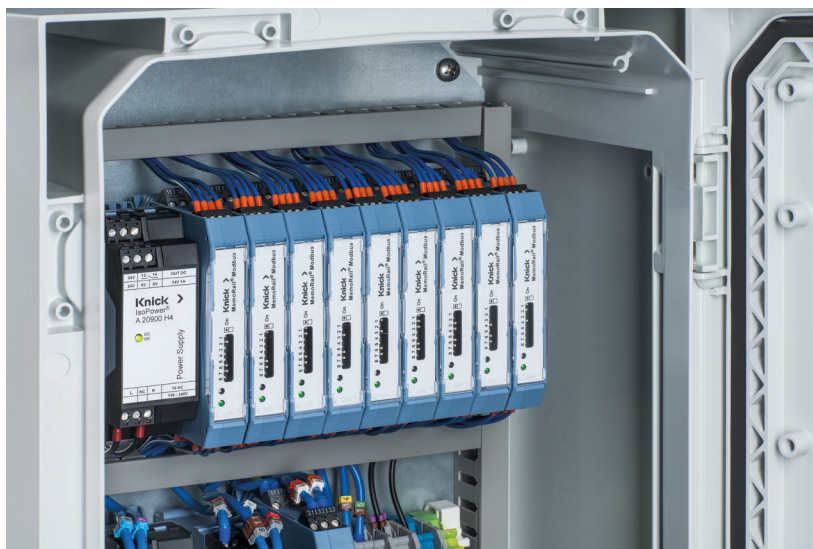
Installation in einem Schaltschrank
